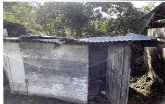
Foto 4: Estructura de madera en pésimas condiciones.
