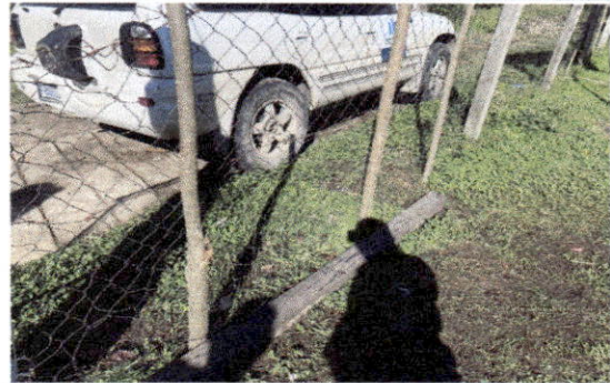
Foto 2: Malla en malas condiciones.
