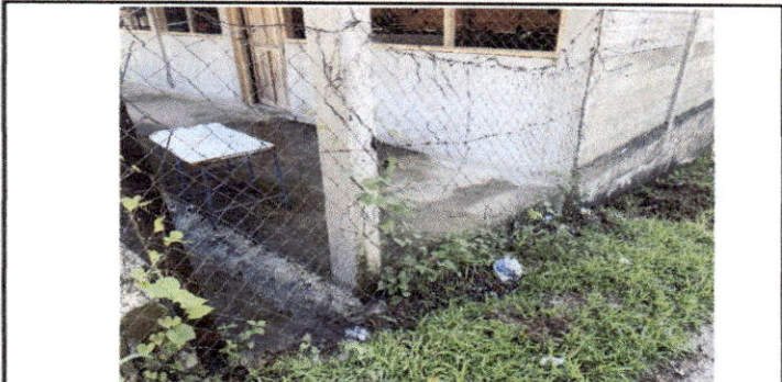
Foto 10: Malla demasiado destruida.
