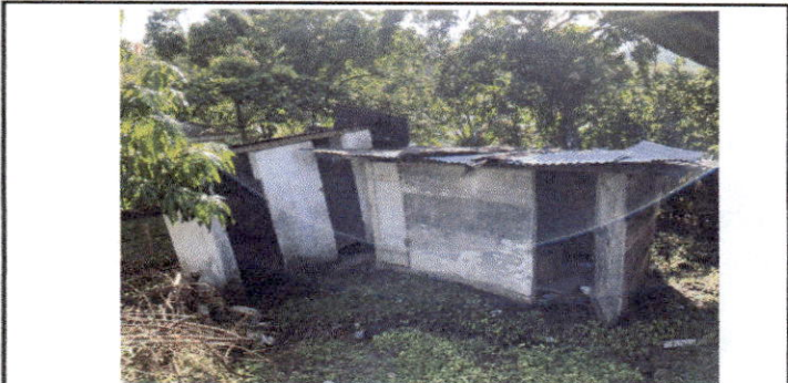
Foto 8: Servicios sanitarios en pésimas condiciones.
