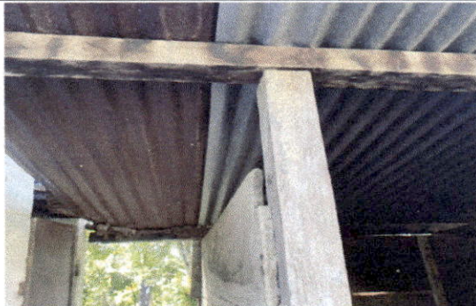
Foto 3: Láminas en mala condición.
