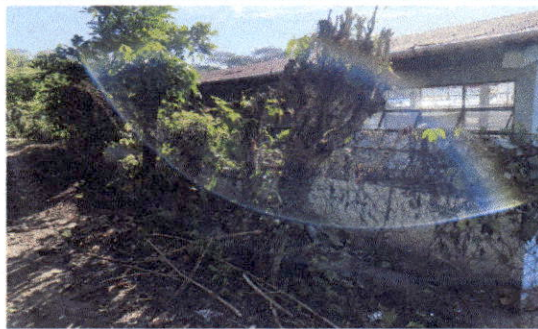
Foto 5: Cercado de malla oxidada.
